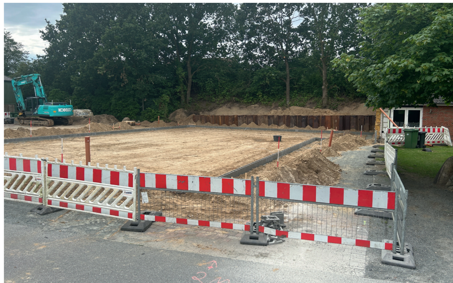
Die Frostschürze für das neue Gemeindehaus liegt am 26.07.2024 – Bild: Peter Lorenz Greisen
